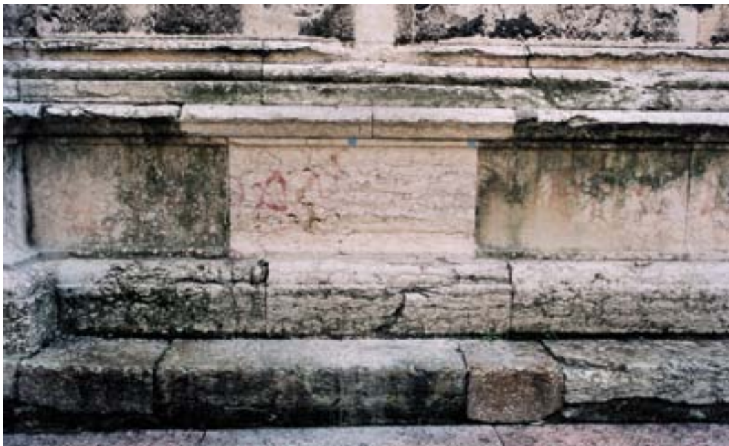
255. Prospetto nord: area campione selezionata sul basamento della navata per l'applicazione di prodotti biocidi diversificati. Superficie di sinistra trattata con New Des; superficie di destra trattata con Biotin-N
